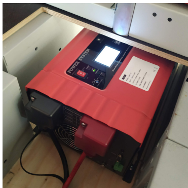
INVERSEUR ET BATTERIE AUXILIAIRE INVERTER AND AUXILIARY BATTERY
